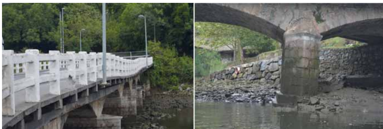
Figura 12. Descensos y giros en pila como consecuencia del deterioro progresivo de las cimentaciones profundas (pilotes) del puente de Astiñene (S. Sebastián). Fotos de los autores (2017)
