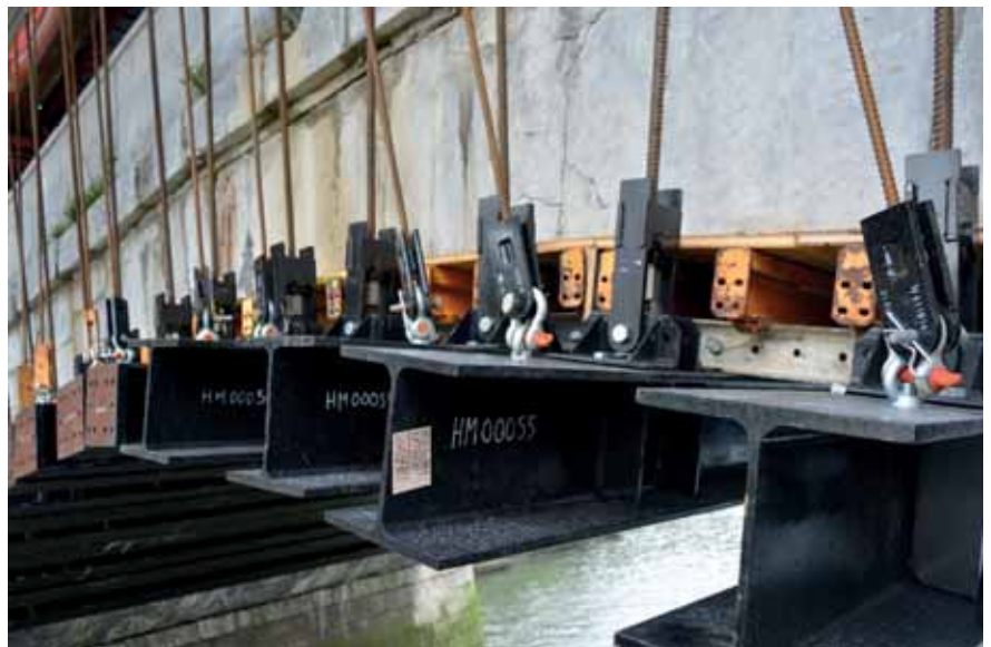
Figura 11. Apeo de las bóvedas del puente de Deba y aprestes dispuestos para su sujeción. Desarrollo de ULMA a partir de la propuesta de FHECOR-INJELAN. Fotos de los autores
