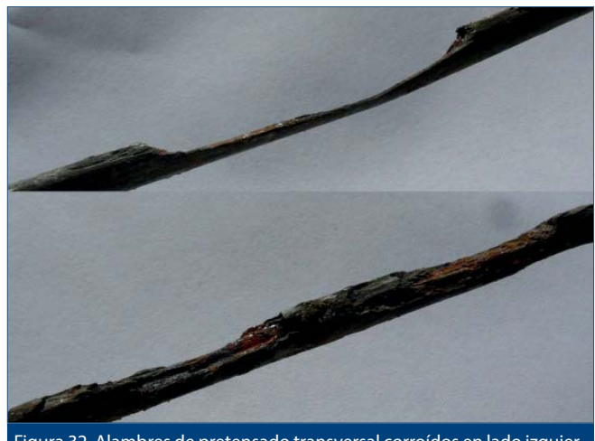
Figura 32. Alambres de pretensado transversal corroídos en lado izquierdo, en losa sobre viga 2
