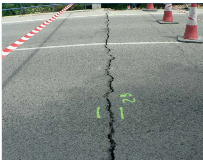
Figura 14. Junta oculta bajo pavimento pero abierta. Al final de la mañana del 29 de mayo, crecía la abertura a razón de 1 cm/h
