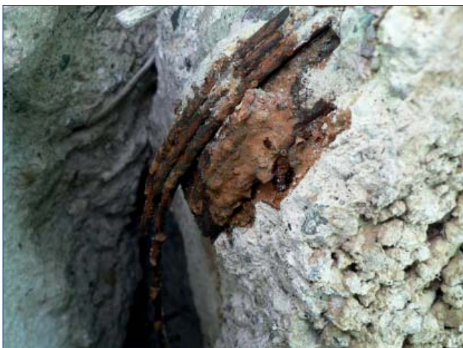
Figura 31. Tambor de anclaje pasivo en lado izquierdo, con corrosión
