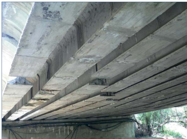
Figura 13. Vista de la cara inferior del tablero desde lado izquierdo hacia E-2. Vigas rotas en secciones diferentes
