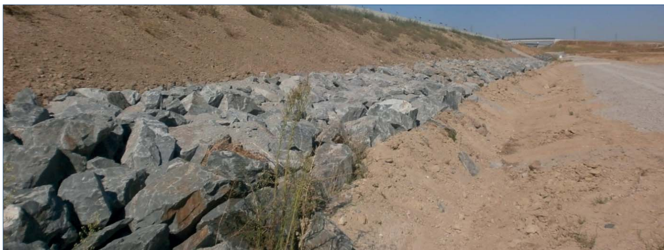
Figura 14. Caso RIB. Protección de escollera (A3). Línea de Alta Velocidad Pozal - Villaverde
