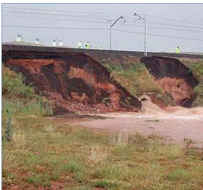
Figura 5. Rotura de un relleno por superación de la capacidad de drenaje transversal. FFCC Alcázar de San Juan – Sevilla, p.k. 150 (Paniagua, I., 2011)
