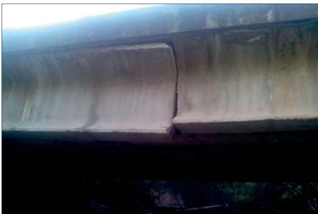
Figura 10. Vista de la viga 1 (lado izquierdo) en la tarde del 28 de mayo de 2015. (Cortesía de Javier de Juanas de ACEINSA.)
