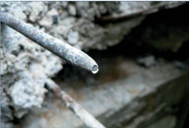
Figura 20. Vista de alambre roto el día 29 de mayo. La pérdida de sección obligó a los no rotos por corrosión a movilizar toda su capacidad
