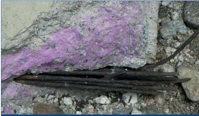
Figura 29. Cordones longitudinales rotos por corrosión en viga 1, lado izquierdo, cara inferior de viga (muestras entregadas el 10 de junio de 2015). Entorno de hormigón prefabricado aún no carbonatado
