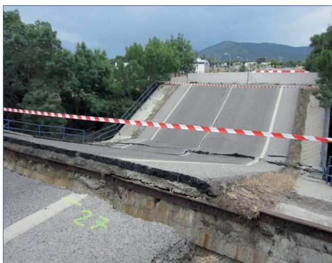
Figura 17. Tablero colapsado hacia a las 14:45 del 29 de mayo de 2015. Vista desde E-1
