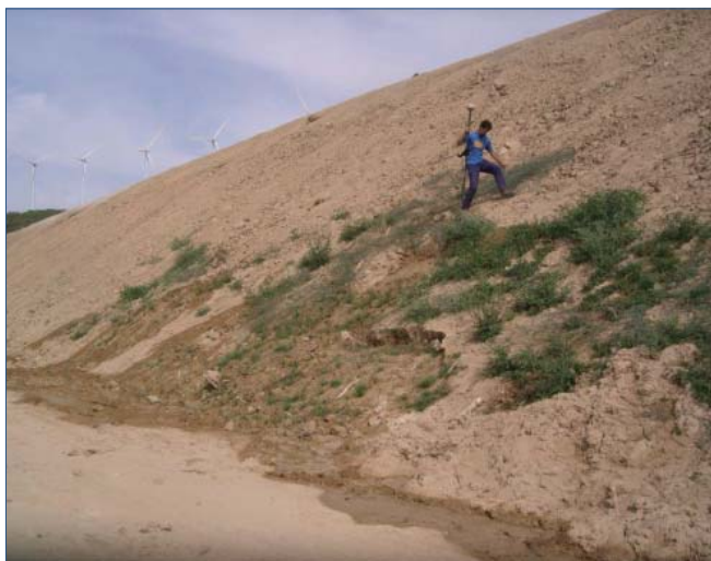
Figura 4. Humedades en pie de relleno con pequeñas roturas incipientes. Canal de Navarra
