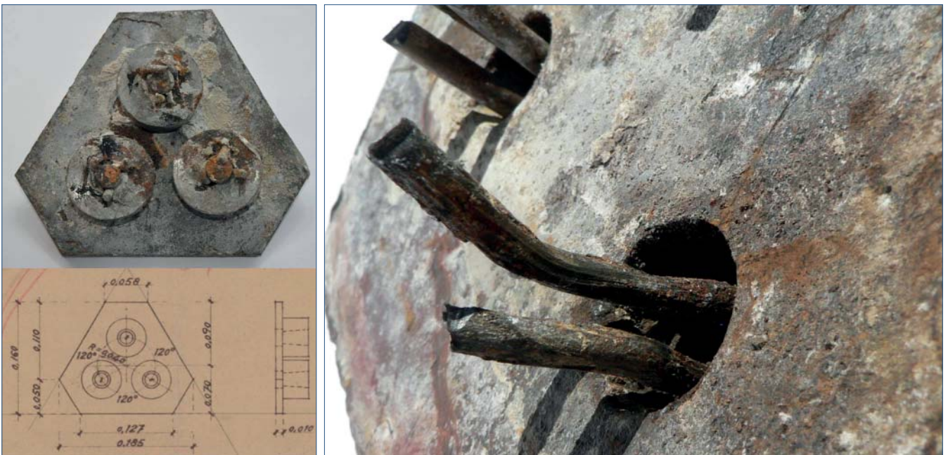
Figura 28. Cabezas de anclaje del pretensado longitudinal parabólico y corrosión incipiente en alambres tras la placa
