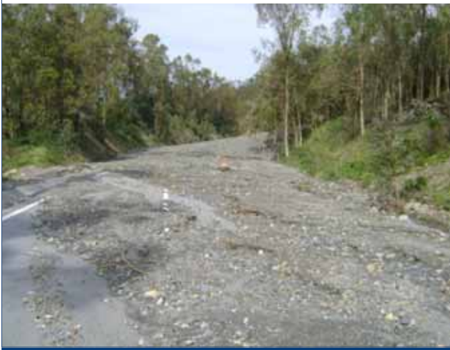
Figura 20. Detalle de la erosión hídrica sobre el talud de desmonte y arrastre de materiales sobre la carretera
