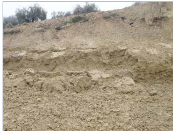
Figura 17. Detalle del talud colapsado
