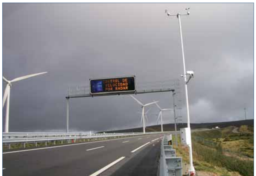
Figura 1. Equipamiento ITS instalado en un tramo de la A-8 recientemente puesto en servicio Fuente: Dirección General de Carreteras del Ministerio de Fomento
