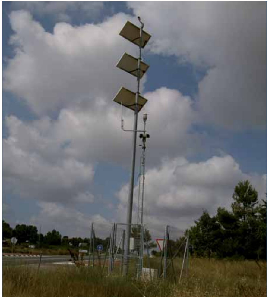
Figura 4. Estación meteorológica instalada en carretera Fuente: Generalitat Valenciana
