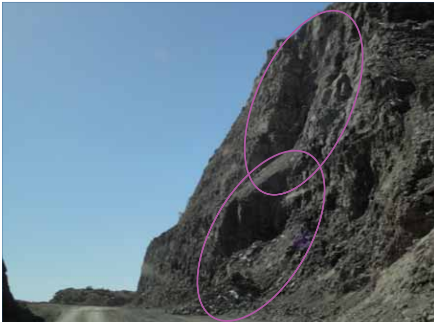
Figura 2. Vista del contratalud 16700 hacia progresivas decrecientes con los dos deslizamientos remarcados
