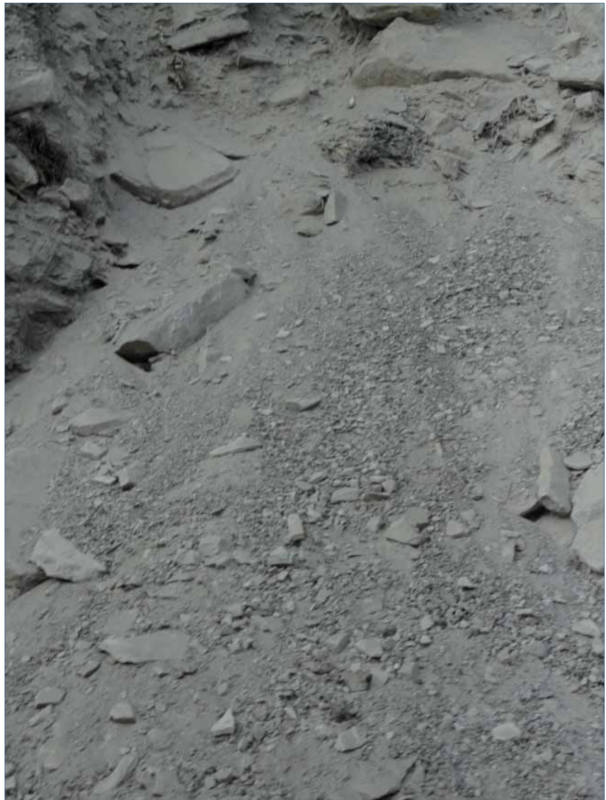
Figura 6. Vista con mayor detalle del material deslizado de contratalud de progresiva 16 700
