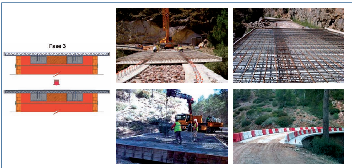
Figura 12. Actuación en Fase 3, hormigonado de vigas de apoyo, disposición de prelosas y acabado de la losa.
