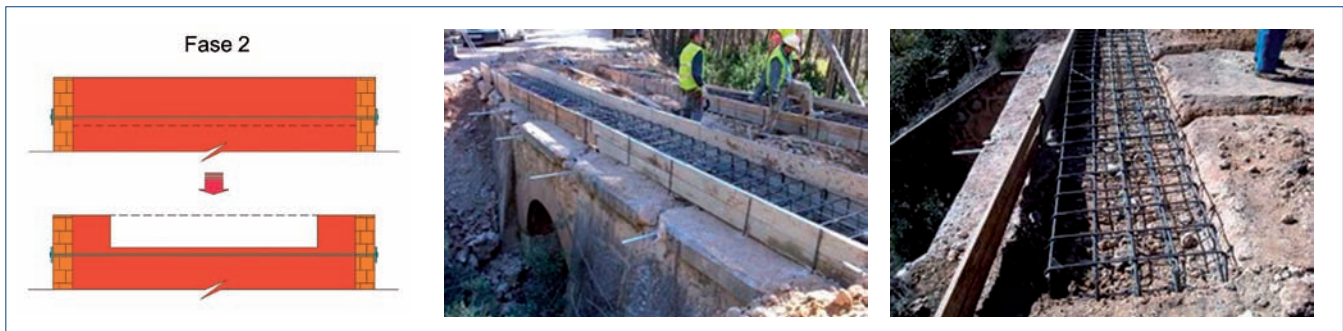
Figura 11. Actuación en Fase 2 de barras transversales de atado y excavación para vigas de apoyo.
