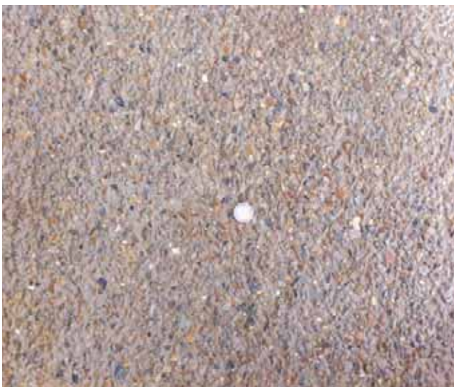
Figura 13. Detalle de tramo con textura de árido visto bien terminada.
