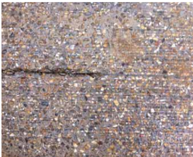
Figura 17. Detalle de junta con tramo deteriorado por el fresado y tramo con mortero sin deteriorar.
