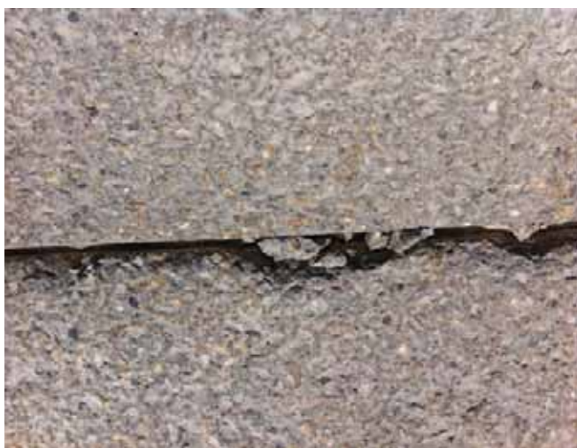
Figura 19. Junta rota tras el fresado por no volverse a serrar a tiempo y reparación.
