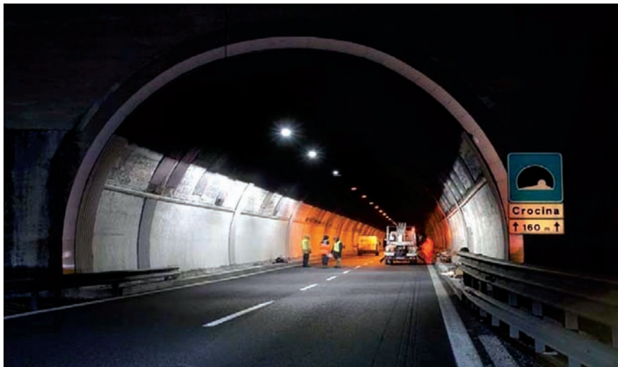
Figura 12. Túnel de Crocina. Italia (Led y VSAP).
