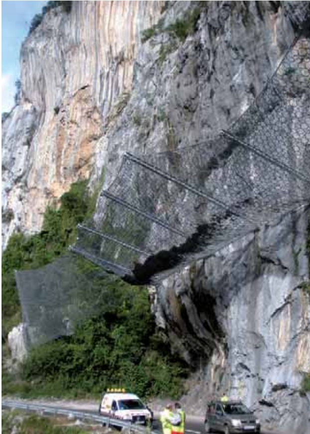
Figura 20. Pantallas dinámicas de tipo galería ancladas a la pared rocosa, a la altura del p.k. 161,2
