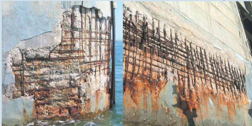
Detalle de daños en zona marina.
