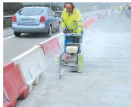
Foto 16. Serrado de la junta longitudinal entre carriles.
