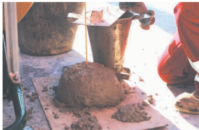
Foto 22. Ensayo de cono de Abrams del hormigón que permite abrir a las 3 horas al tráfico.
