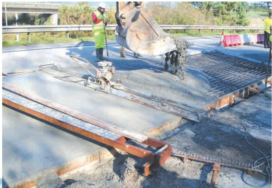
Foto 7. Detalle del hormigonado repartido con el cazo de la pala y vibrado con regla.
